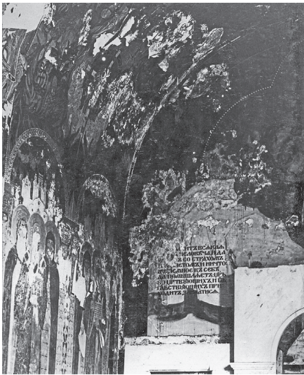
Uszkodzone przez wilgoć freski na ścianie soboru stan w roku 1923, przed przystąpieniem do burzenia świątyni (ze zbiorów archiwum Warszawskiej Metropolii Prawosławnej).
