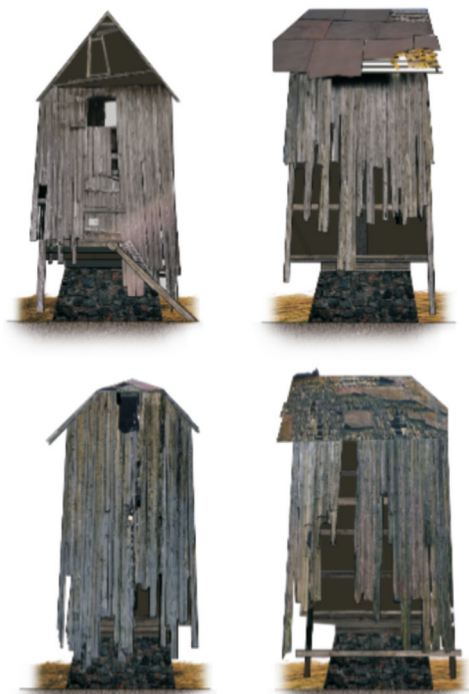
Il. 13. Elewacje wiatraka w Minkowcach, stan z lipca 2021 r., źródło: oprac. własne
